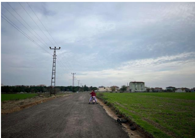
Kemalpaşa Mahallesi Üsküdar Sokak Asfalt Kırığı 5000 m 2
